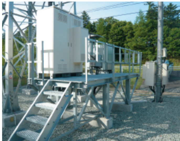
■ 機器収容箱基礎架台
