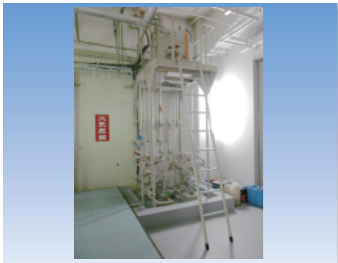
■ 燃料小出槽架台
