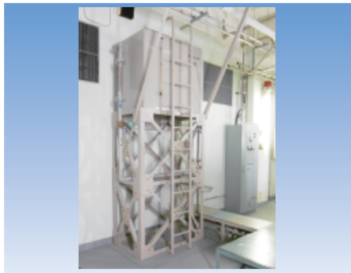
■ 補助水槽架台
